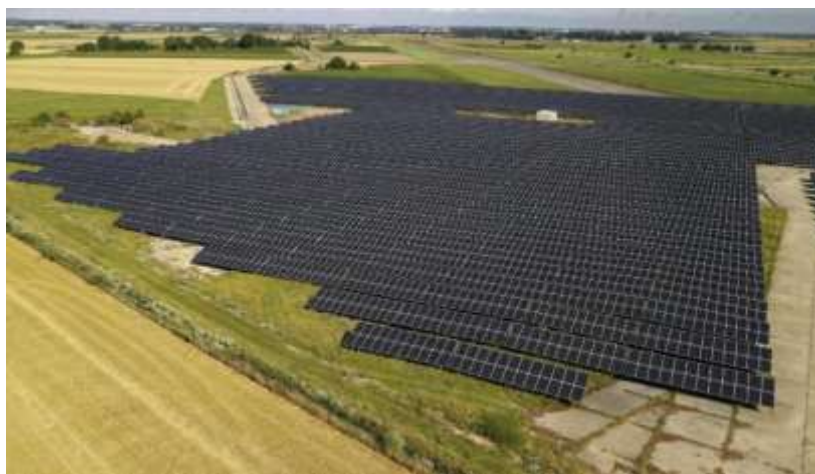
La centrale photovoltaïque de Niergnies près de Cambrai (Photo autorisation la Voix du Nord)
