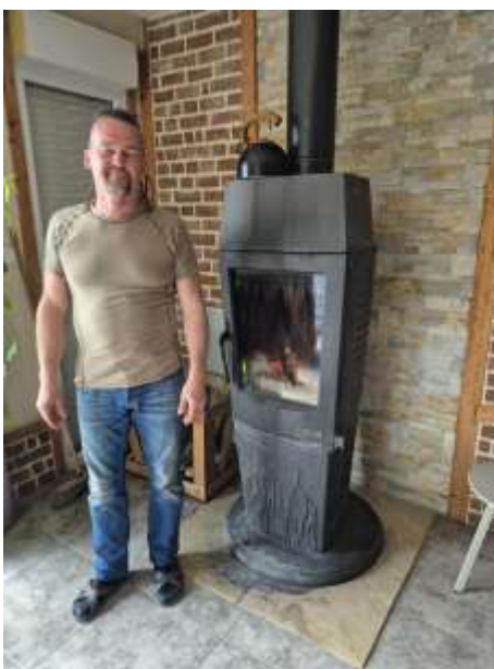
Cet unique poêle à bois parvient à chauffer toute la maison (photo Le Hublot)
