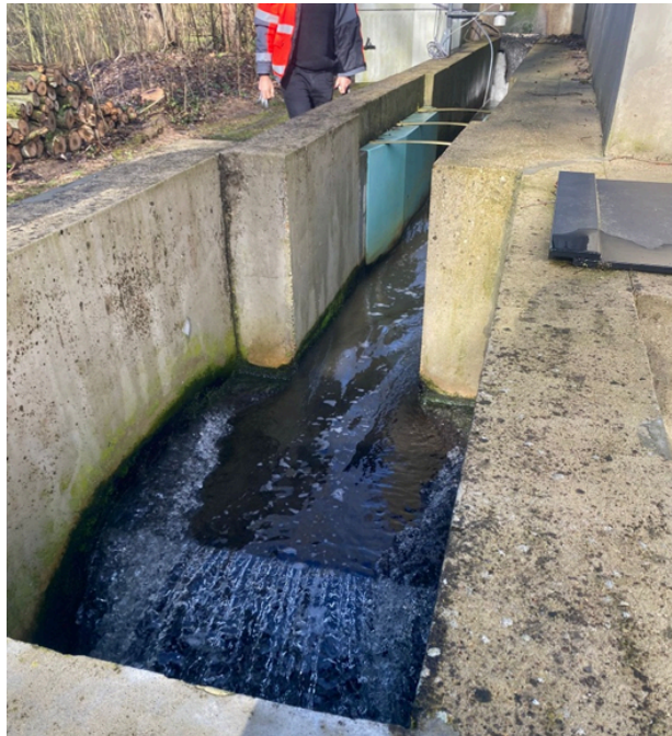
L'eau traitée en sortie de station et qui va rejoindre l'Oise
