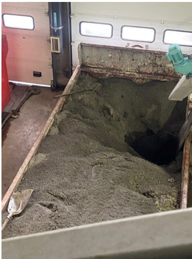
Stockage des boues avant traitement à la chaux
